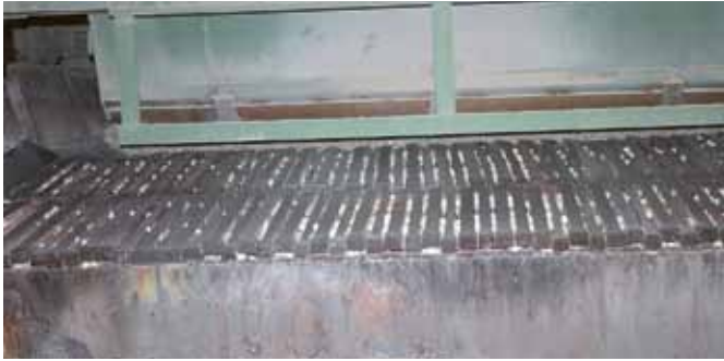
Der Rostbelag der Doppelschicht-Sinteranlage wird durch eine Schicht gebrannter Schamotte vor den hohen Temperaturen im Tunnelofen geschützt.
